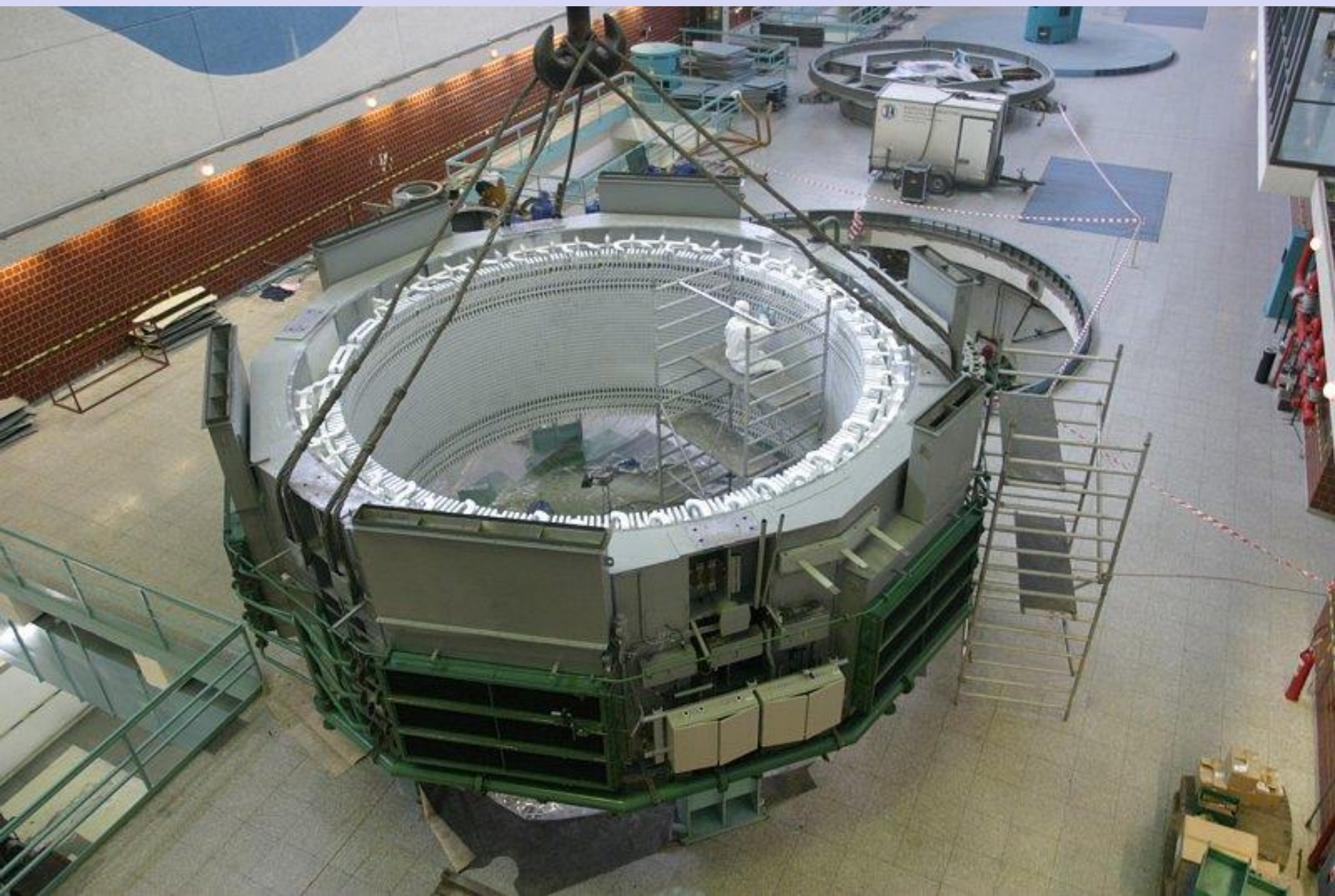
Elektrownia wodna Nidzica
